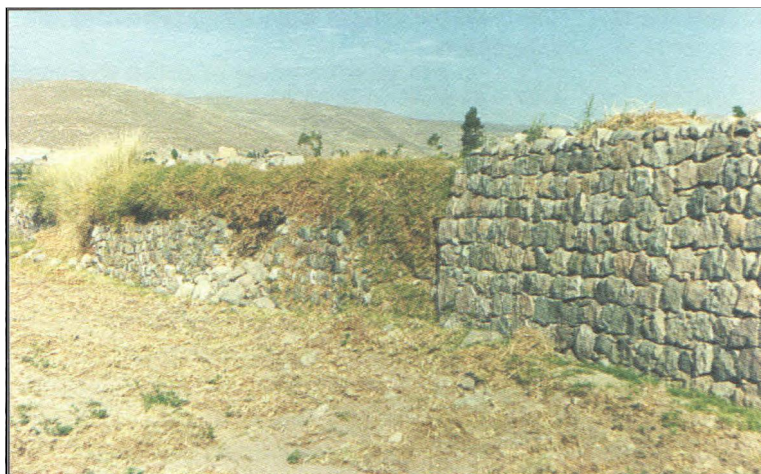
Foto 2. Mitad izquierda: muro en derrumbe progresivo, empujado por suelo no cohesivo en condición de deformación parcial para el estado activo de Rankine. Las gramíneas acrecientan el desequilibrio de las piedras. Mitad derecha: muro reconstruido.
